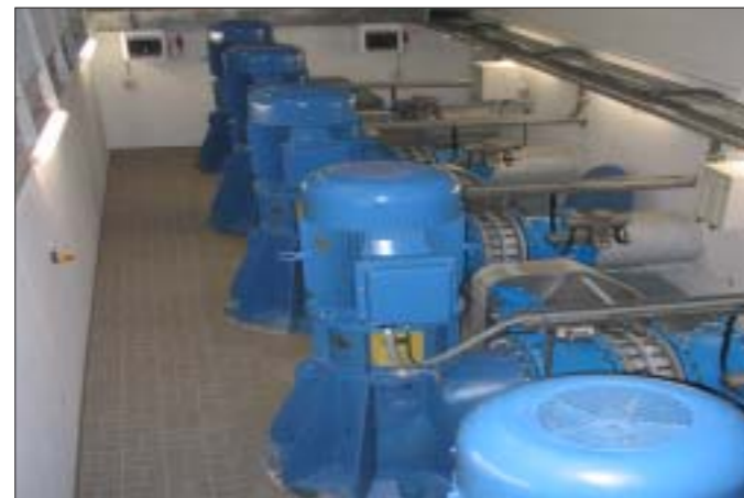
Pumpen im Wörtgrabenschöpfwerk
